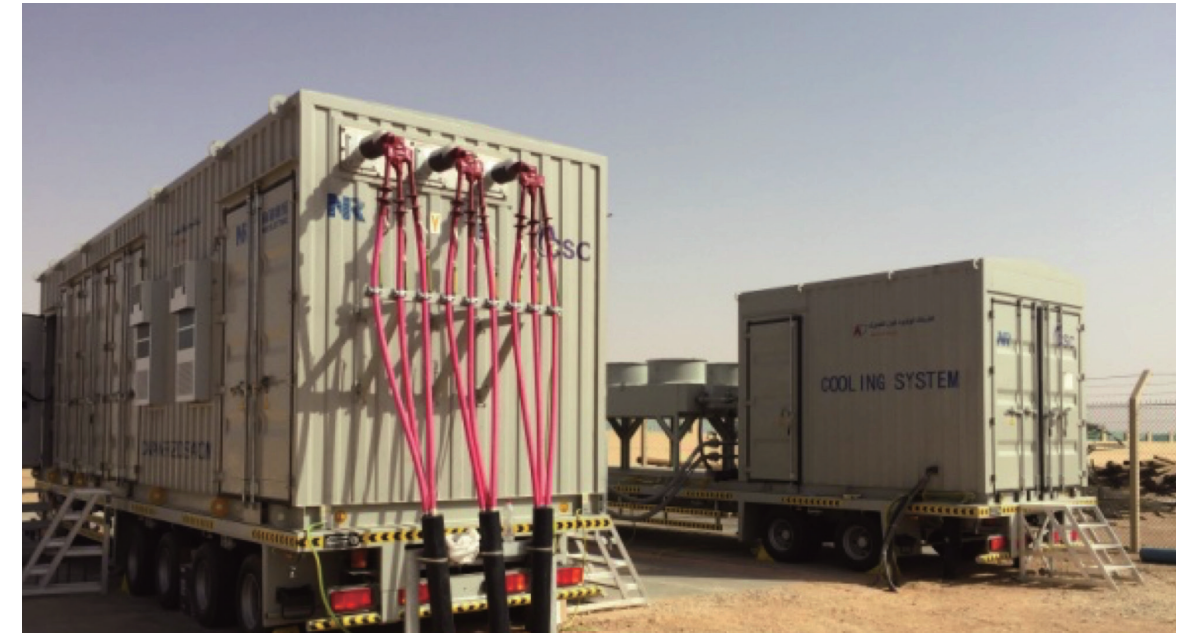
Mobile Statcom Site
